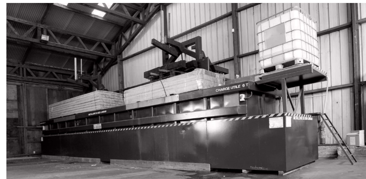
Bac de préservation Classe 2 - Site de Bouguenais (44)
